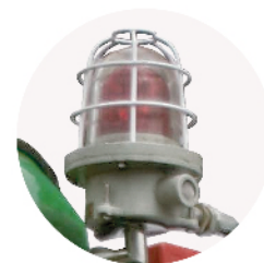
SIRENA DE ACTIVACIÓN DEL SISTEMA
